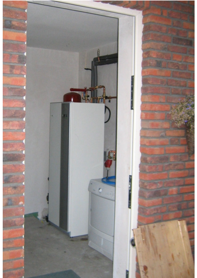
Combiwarmtepomp voor verwarmen, koelen en warm tapwater opgesteld in de bijkeuken
